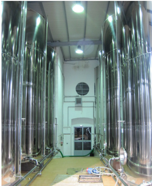
Ilustración 7. Depósitos de acero inoxidable.
