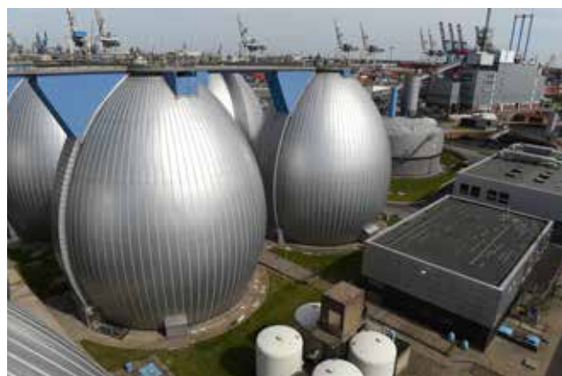
Estación de tratamiento de aguas residuales para producción de biogás
