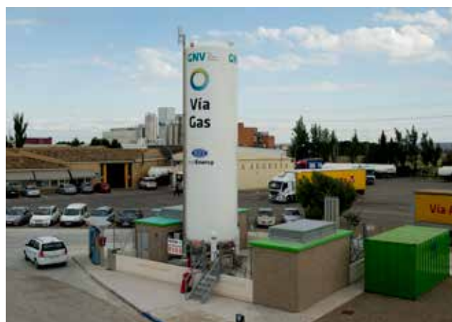
Estación de repostaje de gas natural en Zaragoza
